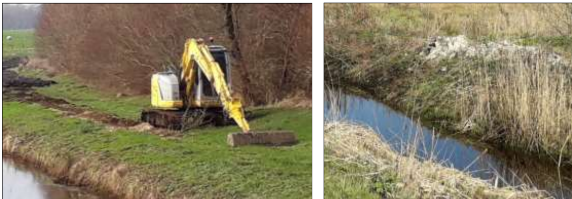
Figuur 3.30 Mechanisch opschonen (baggeren) van de watergangen; de bodem wordt sterk verdiept en de oevers opgehoogd. In de ruimsloot (rechts) is het waterniveau ongeveer een meter lager dan wenselijk is om het veen in stand te houden.
